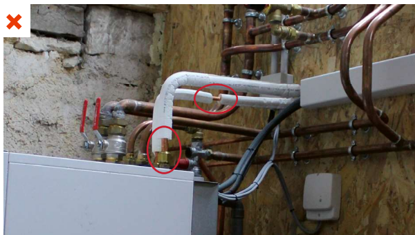
Isolation incomplète du réseau frigorifique. ©AQC
