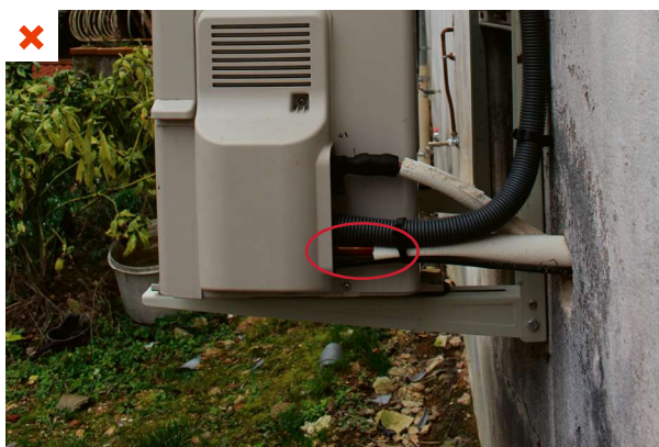
L'isolation du réseau frigorifique est incomplète et s'interrompt avant d'arriver à l'unité extérieure. En outre, la traversée du mur par les réseaux n'est pas étanche. ©AQC
