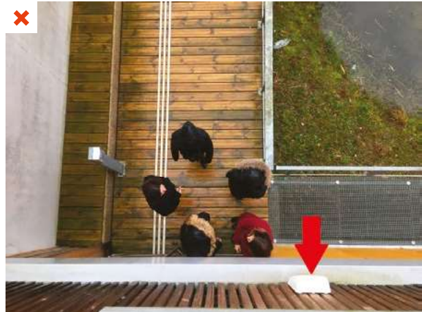
La prise d'air est située au-dessus de l'espace fumeur. Les fumées de cigarette entrent dans le bâtiment. ©AQC
