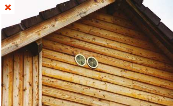
La prise d'air neuf et le rejet d'air vicié sont juxtaposés ce qui peut induire une réintroduction de l'air vicié dans le bâtiment. ©AQC
