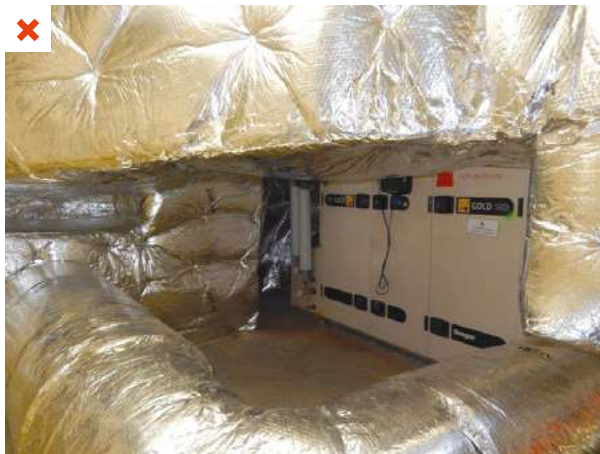
Le cheminement et l'encombrement du réseau aérouique empêchent un accès aisé à la CTA. ©AQC
