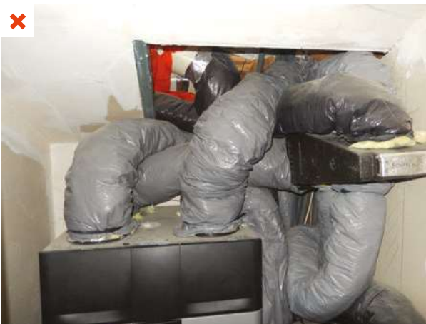
Des coudes et des écrasements de gaines souples sont présents à proximité immédiate de la CTA ce qui engendre des pertes de charges importantes. ©AQC
