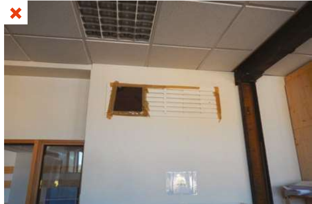
Dans cette école, une partie de la grille d'insufflation a été obturée car un courant d'air gênant était ressenti par les occupants. ©AQC
