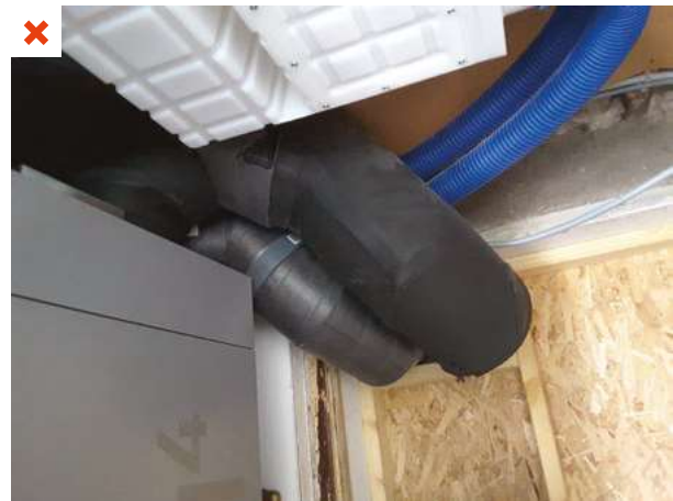
Les gaines de la prise et du rejet d'air sortent l'une à côté de l'autre sur la paroi extérieure. Cette installation a été réalisée dans le cadre d'une rénovation avec une contrainte d'espace. ©AQC
