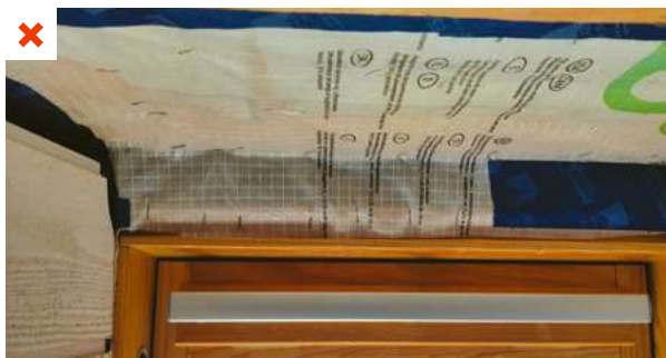
La membrane est fixée sur le dormant de la menuiserie avec des agrafes assurant une tenue mécanique. En revanche, l'étanchéité à l'air n'est assurée ni par un adhésif ni par un mastic. ©AQC
