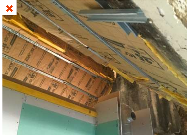
Les extrémités des panneaux isolant ploient sous leur propre poids, notamment au faitage à la jonction entre les deux pans de toiture. ©M.Auriac
