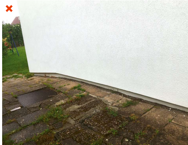
L'absence d'isolation des soubassements crée un pont thermique au niveau de la dalle basse. ©AQC
