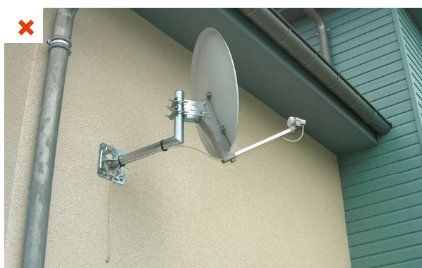
Une antenne parabolique a été installée après la réception de l'ITE. Le fil traverse l'ITE et le mur support. L'étanchéité à l'air du mur support et l'étanchéité à l'eau de l'ITE sont dégradées. ©AQC
