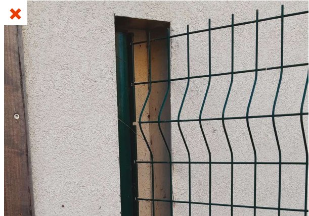
L'interruption de l'ITE au droit du poteau de fixation de la clôture engendre un pont thermique. ©AQC
