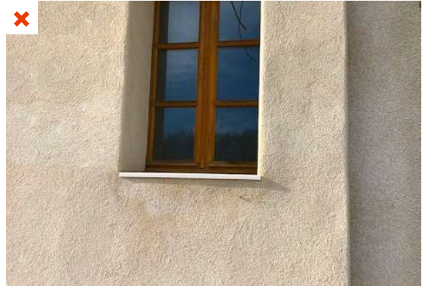
L'isolation par l'extérieur de cette maison s'arrête au niveau du mur mitoyen séparant les deux propriétés. Aucun retour d'isolant par l'ITI n'a été prévu sur ce mur. ©AQC
