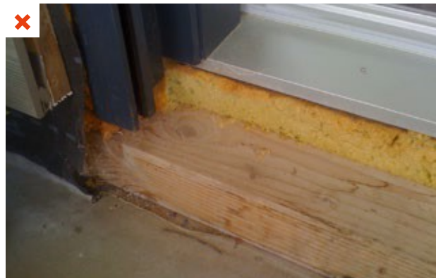
Choix d'un produit inadapté (mousse polyuréthane) ne permettant pas un calfeutrement fonctionnel et durable. ©AQC
