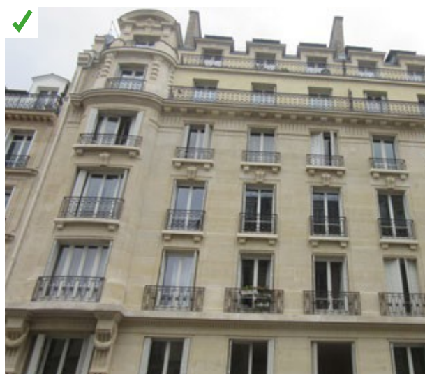
Exemple d'un bâtiment classé où toutes les menuiseries ont été remplacées à l'identique (nature, dimensions, emplacement, quincaillerie, couleurs...) ©AQC
