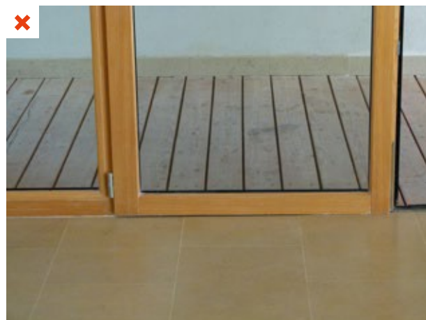
Sous dimensionnement des pommelles qui a conduit à un affaissement de la menuiserie. La porte est difficilement manœuvrable car elle touche le sol. ©AQC
