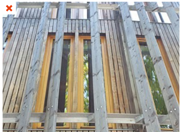
Difficulté d'accès pour l'entretien des menuiseries extérieures due aux ventelles. ©AQC
