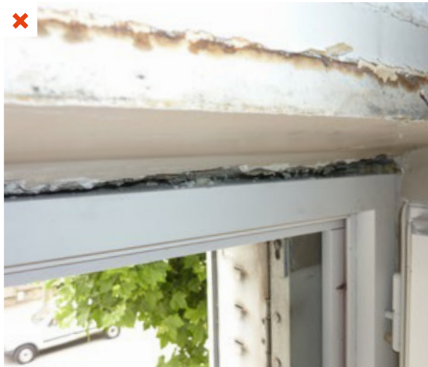
Irrégularité du support qui ne permet pas une pose convenable de la mousse imprégnée pré-comprimée. ©AQC
