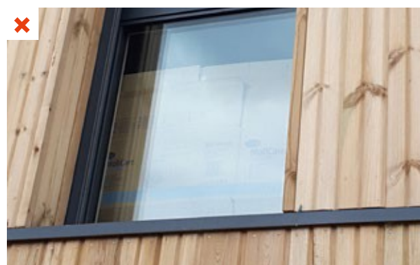
Élément à risque : présence d'un carton comme protection visuelle au niveau de l'allège qui entraîne un écart de température. ©AQC
