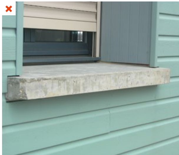
Lors de la rénovation la menuiserie n'a pas été posée dans le même plan que l'isolation (ITE). De plus, l'appui de fenêtre non isolé est à l'origine d'un pont thermique conséquent. ©AQC
