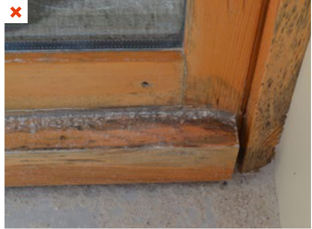
La partie basse de la menuiserie est la plus vulnérable car la plus exposée aux intempéries. ©AQC
