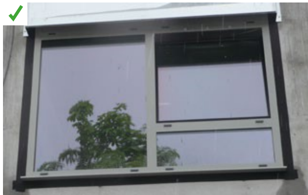
Solution corrective : rajout d'une bande d'étanchéité posée en applique extérieure pour améliorer l'étanchéité. ©AQC
