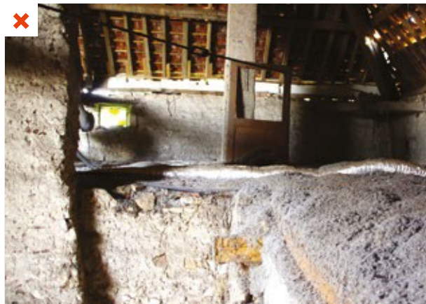
Le pourtour de la zone à isoler n'a pas été délimité. L'isolant soufflé n'est pas contenu en périphérie et se déverse. ©AQC
