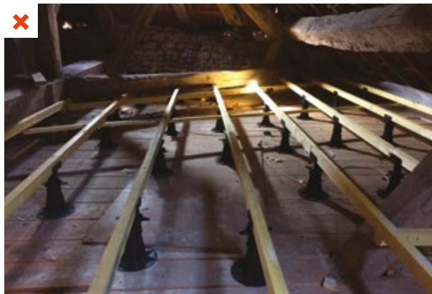
Le plancher bois du comble va recevoir l'isolant mais il n'est pas étanche à l'air. De nombreux passages d'air existent entre les lames. ©AQC
