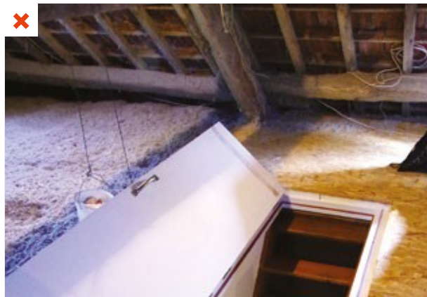
Trappe d'accès aux combles non-isolante. ©AQC
