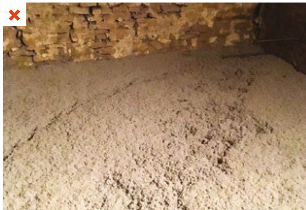
L'isolant a été endommagé suite à l'inspection du comble par le propriétaire. ©AQC
