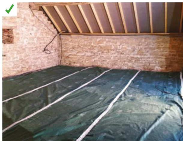
Le traitement de l'étanchéité à l'air a été effectué sur le plancher, avant de recevoir l'isolant. La membrane doit être prévue à cet effet. ©AQC
