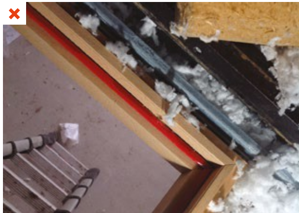
Trappe d'accès à un comble sans maintien de l'isolant sur le pourtour. ©AQC
