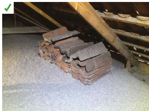
Ces tuiles ne reposent pas directement sur l'isolant. Une plateforme technique isolée a été aménagée pour les stocker. ©AQC
