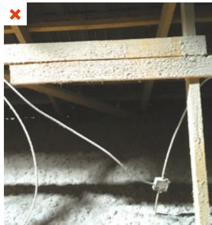
Le boîtier électrique a bien été dégagé de la zone isolée mais il n'a pas été fixé de manière durable sur un élément de charpente. ©AQC
