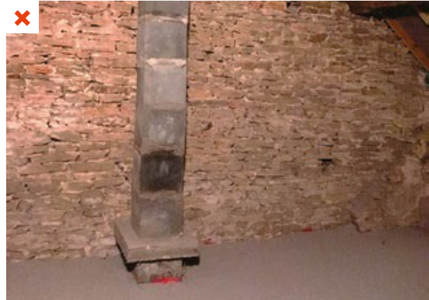
En l'absence de coffrage, l'isolant biosourcé en vrac est au contact direct du conduit de cheminée. Cette configuration n'est pas réglementaire et peut être à l'origine d'un départ de feu. ©AQC
