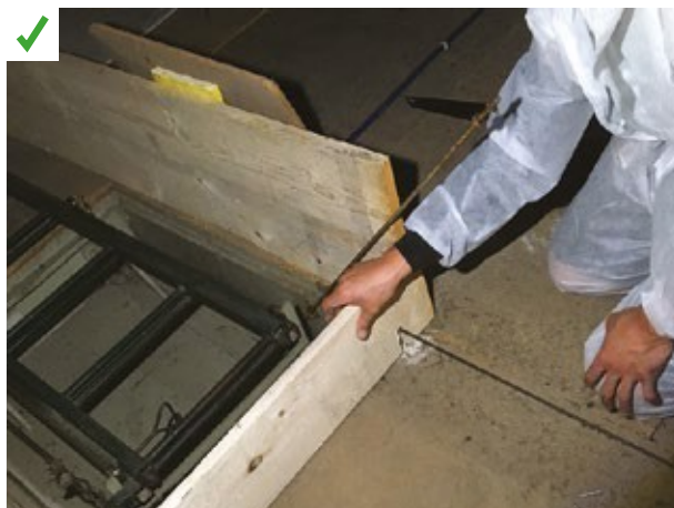
Mise en place d'un coffrage en périphérie de la trappe d'accès pour contenir l'isolant soufflé. ©AQC
