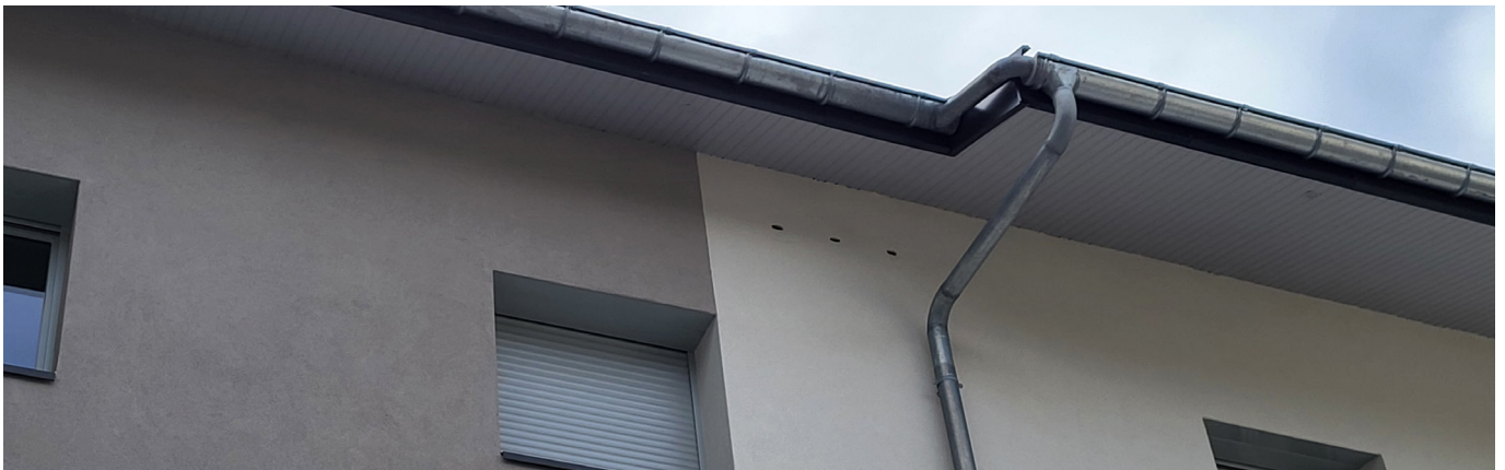
Nichour triple à martinets intégré dans l'isolant sur le site pilote de Grand Aigueblanche (73) © Ilan Badaoui
