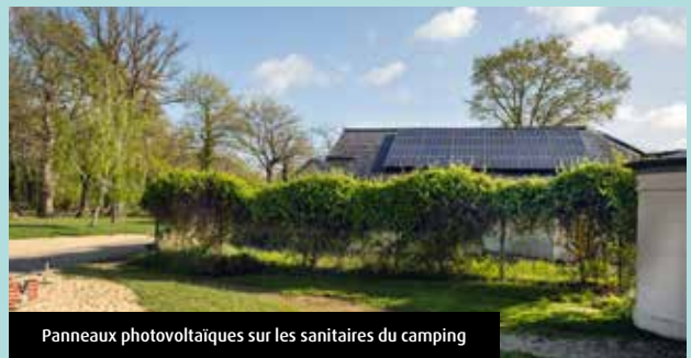
Panneaux photovoltaïques sur la base nautique
